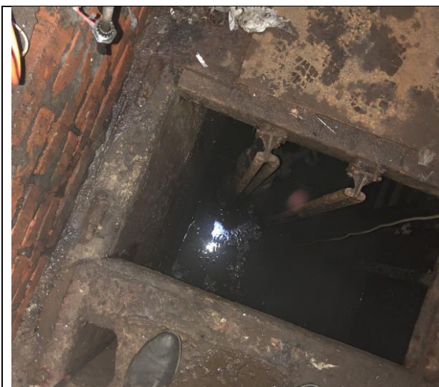
Фото буферной ёмкости КНС №1 до ремонта – буферная ёмкость почти всегда полная.
