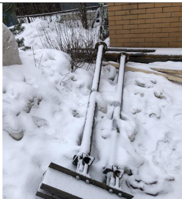
Подготовленные к монтажу трубы
